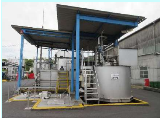
混合調整施設：混合槽（リサイクル燃料）
